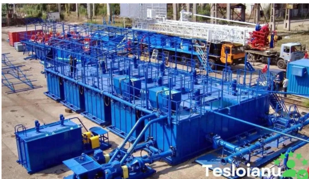
Instalatii mecanice si utilaj tehnologic moreni
